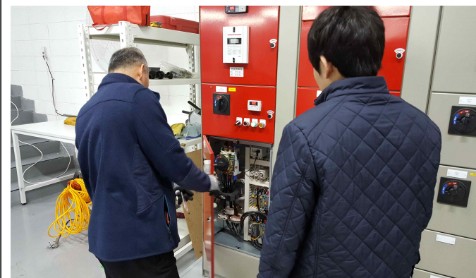
소방펌프 전원 점검
